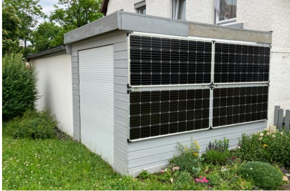
Abbildung 32: Beispiel für Kleinstanlagen an Fassaden (Foto swt)
