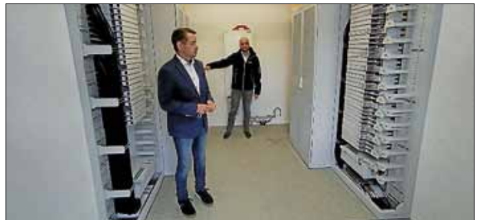
Bürgermeister Uwe Ganzenmüller und Projektleiter Karlheinz Stroppel (NetzeBW) im Hauptverteilergebäude (PoP) am Rathaus
